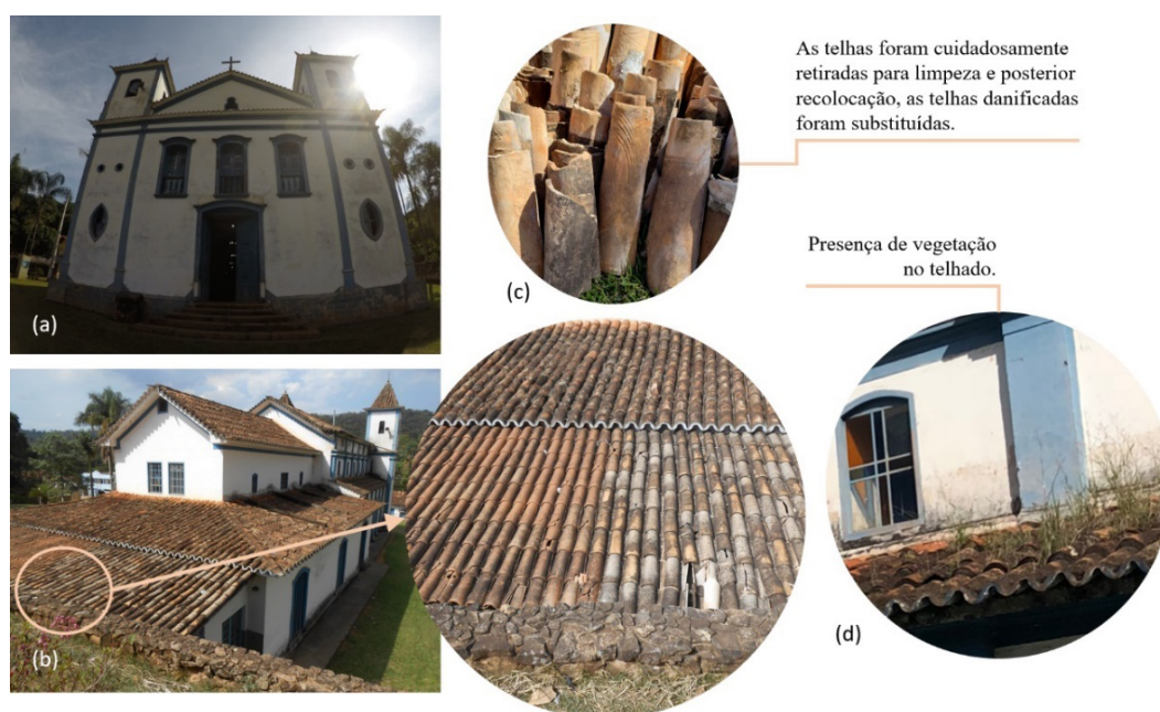
Figura 5 – Igreja Nossa Senhora da Piedade: (a) fachada frontal; (b) telhado da igreja com detalhe para as telhas danificadas; (c) telhas que foram retiradas para limpeza e seleção das que seriam conservadas; (d) detalhe da presença de vegetação no telhado
